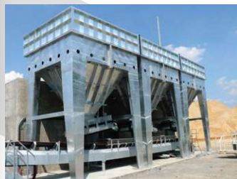
• Trémie à sable et graviers
